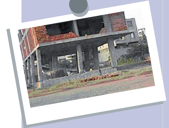
Şekil 29. Yumuşak kat oluşumu sonucu meydana gelen hasar, 1999 İzmit.
