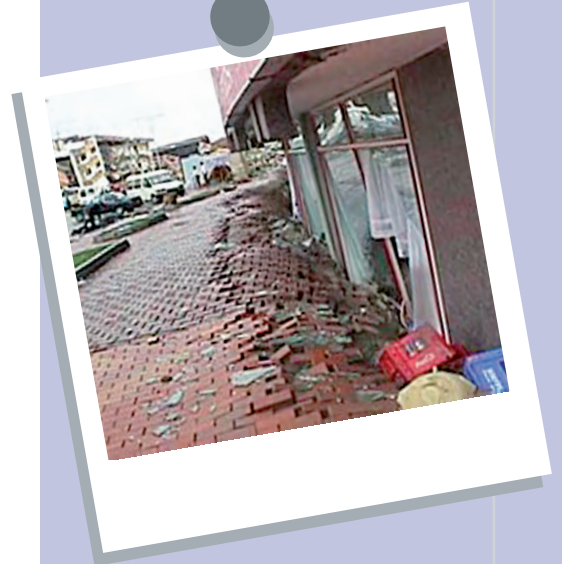
Şekil 21. Sıvılaşma nedeniyle bina oturması.
