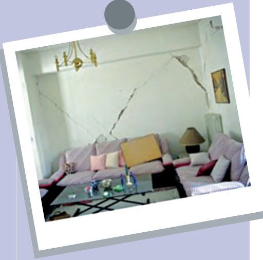
Şekil 32. Dolgu duvarlarda meydana gelen tipik hasar.
