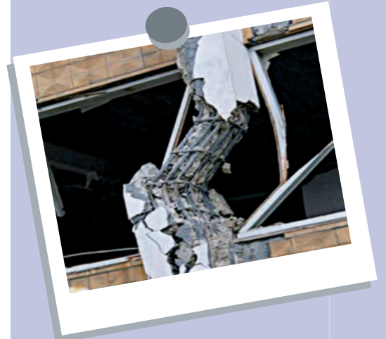
Şekil 39. Kısa kolon hasarı.
