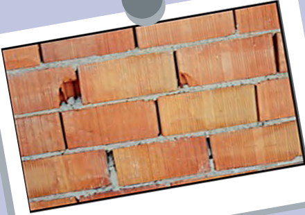
Şekil 60. Kötü örülmüş, düşeyde harç uygulanmamış taşıyıcı duvar.
