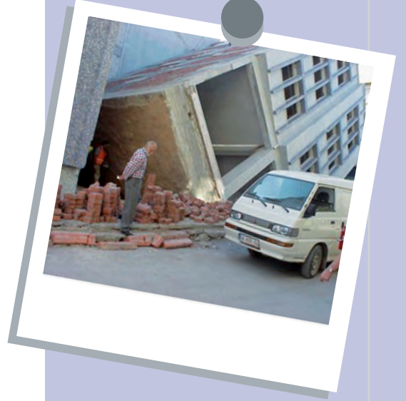
Şekil 20. Sıvılaşma kaynaklı hasar 1999 Kocaeli Depremi, Adapazarı.
