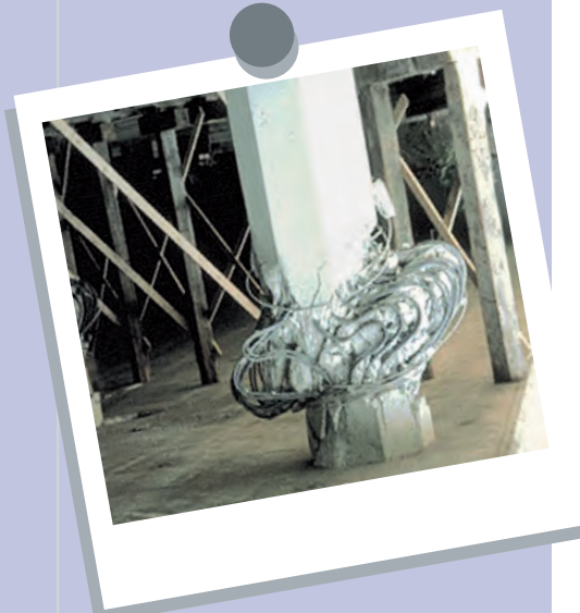
Şekil 46. Enine donatısı yetersiz miktar ve aralıktaki kolon hasarı.
