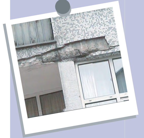
Şekil 48. Dış ortamdaki nemin betonarme elemanda yarattığı korozyon.
