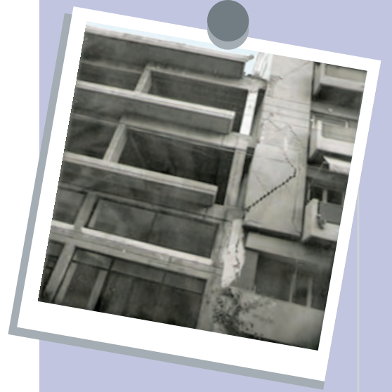
Şekil 36. Bitişik binaların etkileşimi sonucu oluşan hasar.
